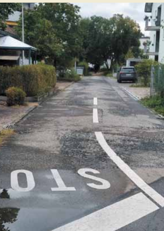
Querstrasse vor Sanierung © 2024 Sandro Fischer
